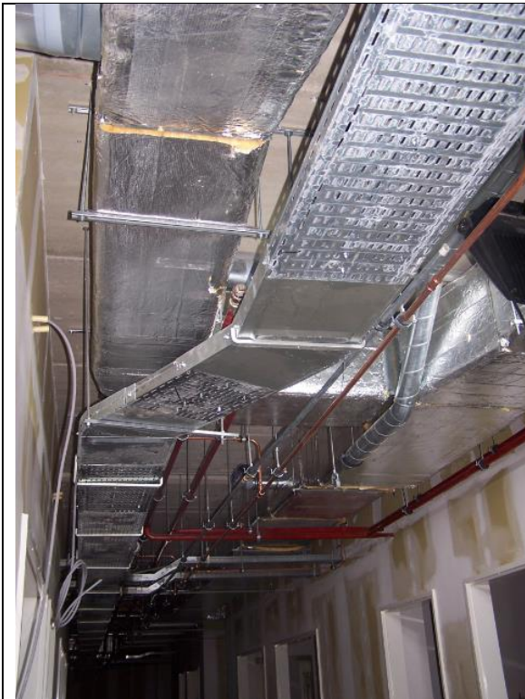
Nu kun je de buizen van de verwarming en de stroom nog zien. Als het af is komt er een plafond.
